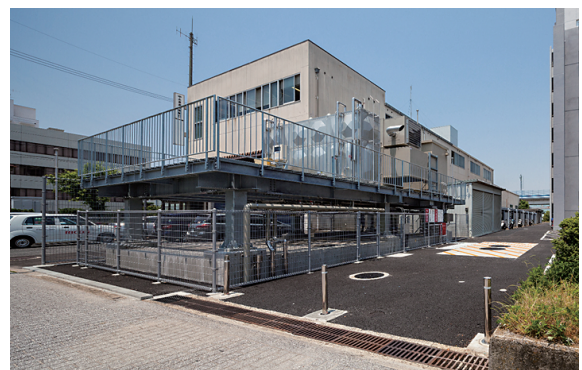
写真2 浸水対策として非常用発電機及び受水槽を屋外に新設した架台上に移設した事例（広島港湾合同庁舎（広島県））
