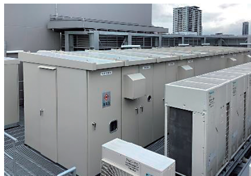
写真2 屋上の高圧受変電設備
