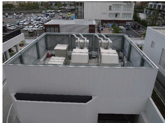
写真6 非常用発電設備の見下ろし
