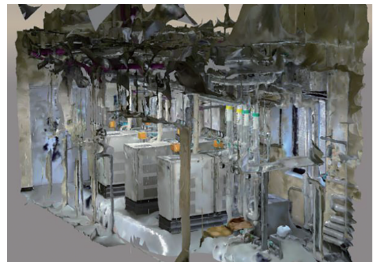
図6 某機械室の3Dモデル
